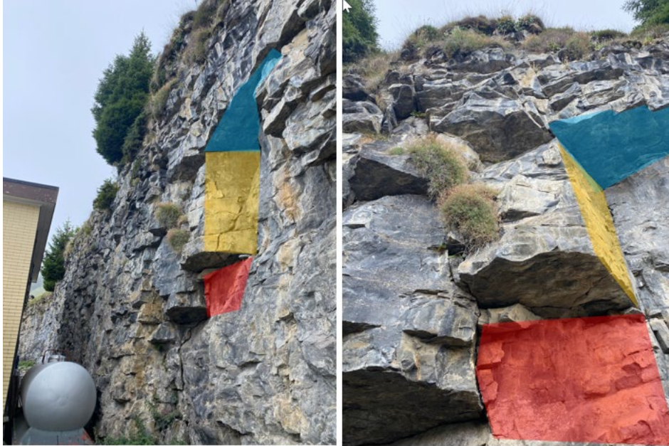
Abbildung 4: Ansichten der Felsanschnitte hinter dem Bahnhofgebäude; Hauptsächliche Trennflächen: blau = Schichtung; rot = unregelmässige hangparallele Klüftung, bzw. Sprengfläche; gelb = vertikale Hauptklüftung (NW-SE streichend)
