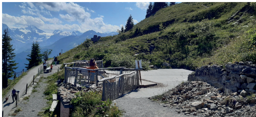
Abb. 10 Bestehende Plattform über der Trafostation, auf welcher der Pavillon gebaut werden soll (eigene Fotografie)
